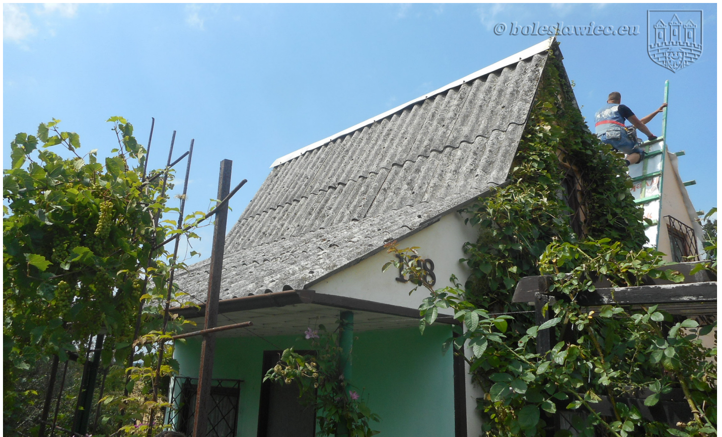
Zakończenie realizacji zadania pn. „Usuwanie azbestu i wyrobów zawierających azbest z terenu Gminy Miejskiej Bolesławiec” w roku 2018.
